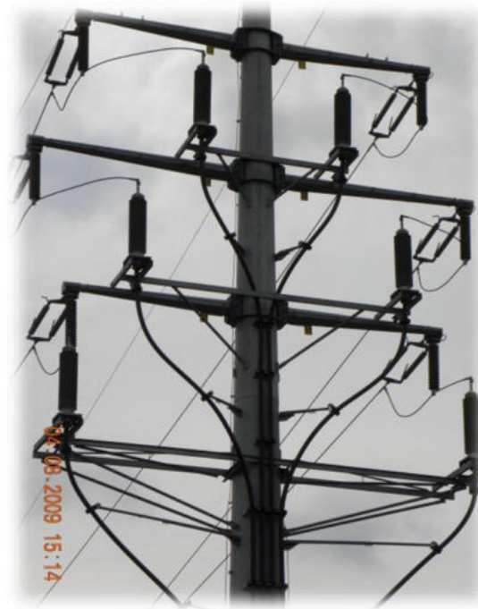
Ograniczniki przepięć na słupach kablowych
