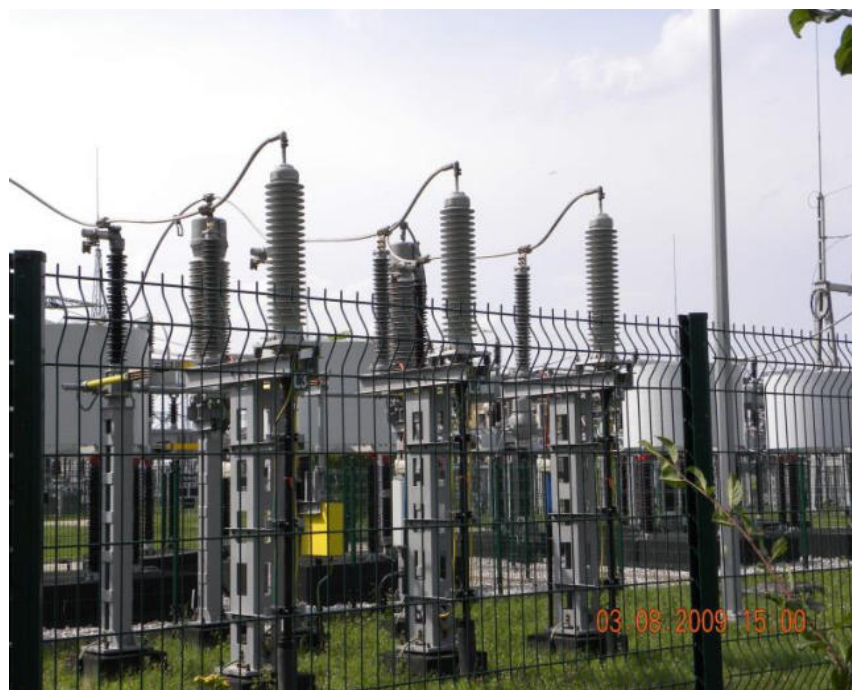
Ograniczniki przepięć na konstrukcjach wsporczych
