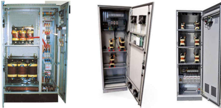
Widok automatycznych baterii dławików
